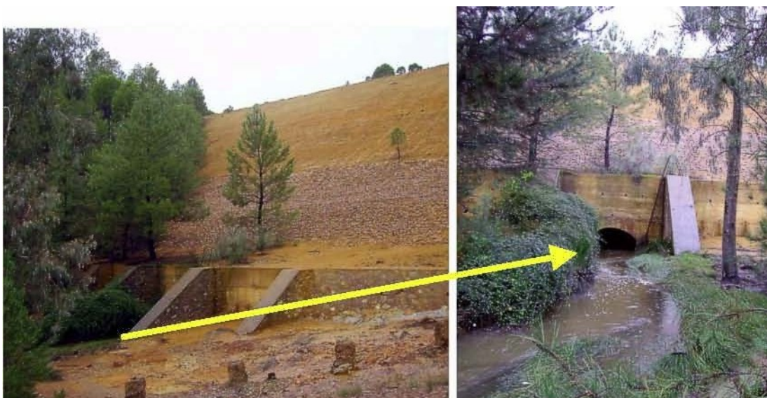
Fotografía 1. Vista del dique oriental de la Represa III. Se destaca la salida del túnel por el que se canaliza el Barranco del Pie de la Sierra
